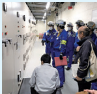
専門業者による受変電盤の点検の事例
